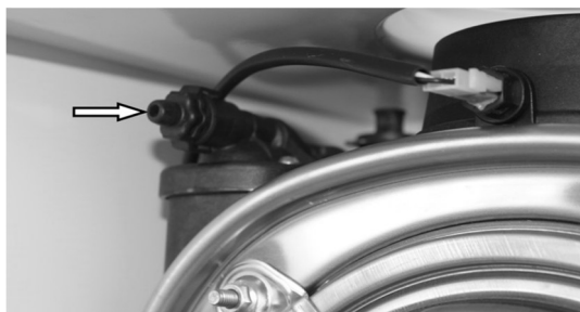
Rys. 20: Odpowietrznik na wymienniku kotła.
