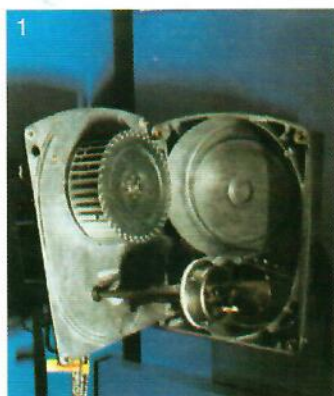
1. Palnik w zawieszeniu do prac serwisowych (lewa)
